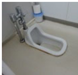
経年による老朽化
